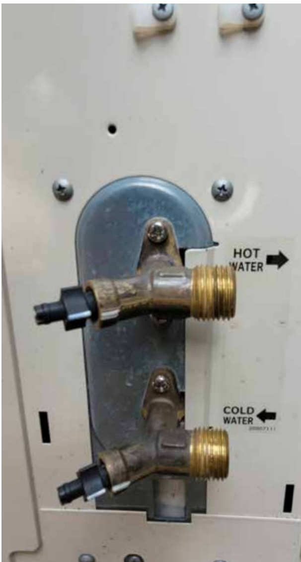
HOT WATER / COLD WATER aansluiting
